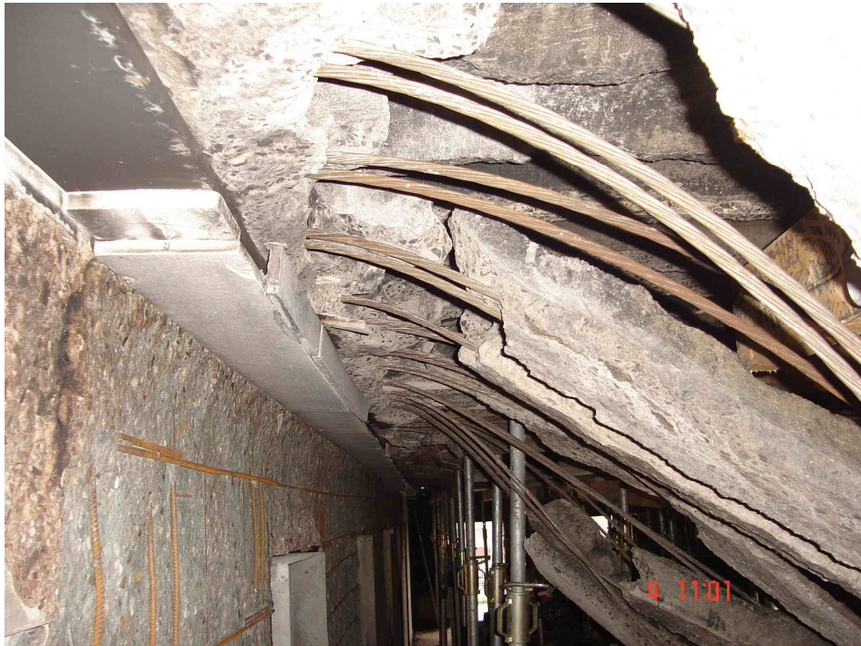
Foto: een bezweken betonconstructie door brand
