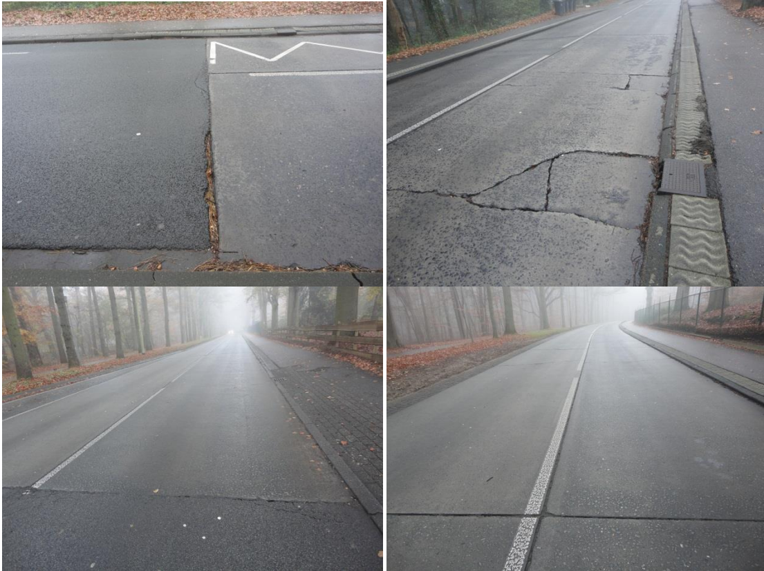
Afbeelding 3: De rijbaan van de N417 is in zeer slechts staat.
